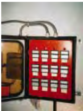
Ωρομετρητές εγκατάστασης θέρμανσης, σε πολυκατοικίες.
