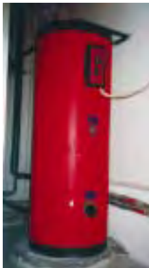
Κεντρικό μπόιλερ ζεστού νερού με θερμομονωτικό κάλυμμα.
