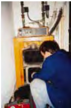
Μια εγκατάσταση που λειτουργεί με βαθμό απόδοσης 78%, μπορεί, μετά τη συντήρηση και την κατάλληλη ρύθμιση, να φτάσει σε μια απόδοση 88,5% μειώνοντας έτσι την κατανάλωση καυσίμου κατά 12%.
